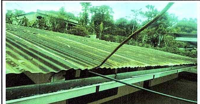
Foto 3: cambio de techo de dos aulas con laminas troqueladas, instalcion eléctrica, accesorio.
